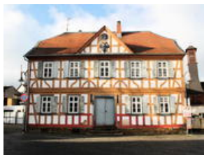
Das Alte Schulhaus sieht auf den ersten Blick recht schön aus. Wer zweimal hinsieht, entdeckt überall kaputte Stellen.
