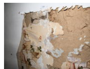
Vieles ist kaputt, die Böden sind uneben, zwei Fenster wurden einfach zugemauert, die Bäder sind uralt.
