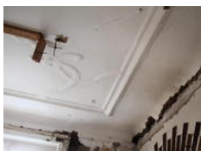
Das wahre Ausmaß des Sanierungsbedarfs zeigt sich im Inneren des Gebäudes.
